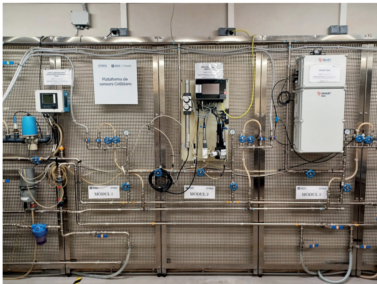
Figura 1. Detalle del circuito hidráulico de la infraestructura para la validación de equipos de monitorización de la calidad del agua.
